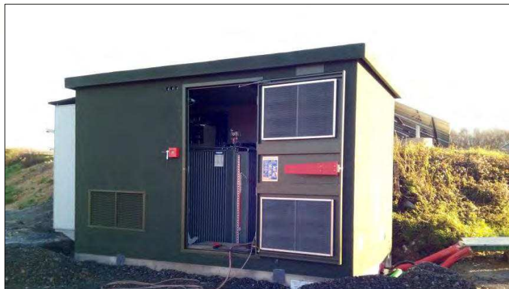
Figure 9 : Photo d'un poste de transformation d'un projet en phase de construction (Source : IEL)
