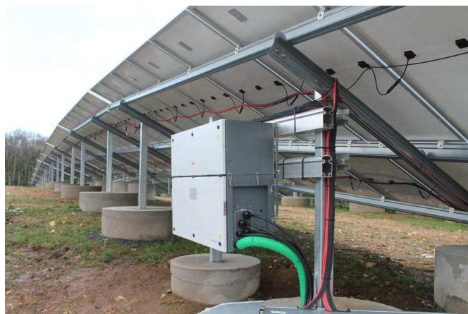
Figure 10 : Photo d'un onduleur d'un projet en phase de construction (FS du Cosquer, ancienne décharge, une réalisation IEL)
